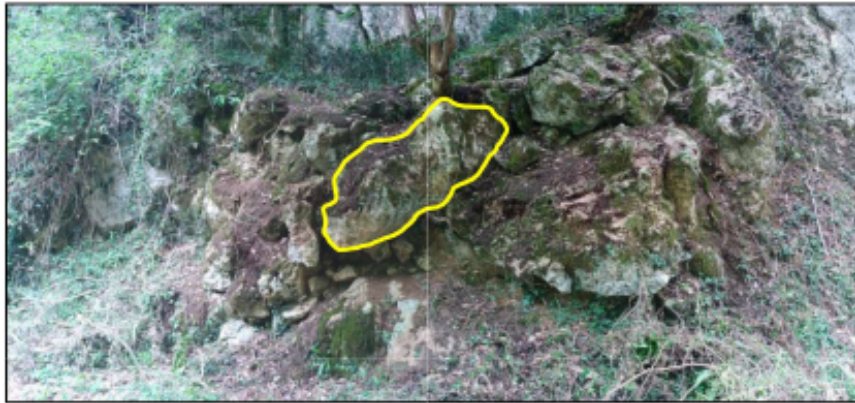
Instabilité I9 (en jaune) observée après dévégétalisation – Photo Ginger CEBTP du 10 septembre 2025
